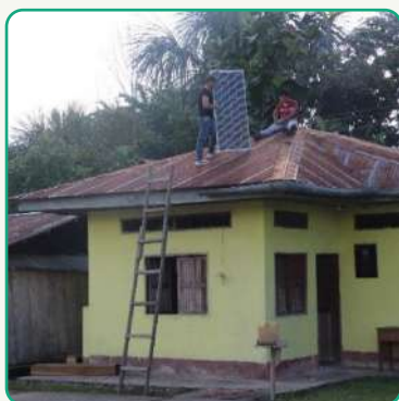
Instalación de sistema solar en botiquín de salud de la comunidad Puca Urco
